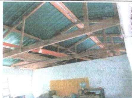
Foto 2: La estructura que sostiene las laminas estan en mal estado, lo que provoca que las laminas se muevan.
