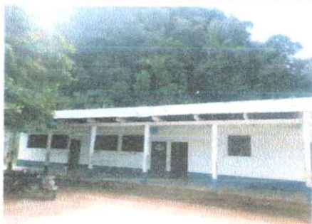
Foto1: Vista del techo de COPB PRE-PRIMARIA, en época de lluvia el agua se filtra.
